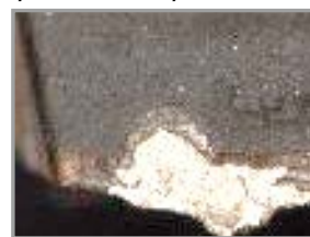
Wiertło konwencjonalne Pęknięcie po przejściu 45 m
